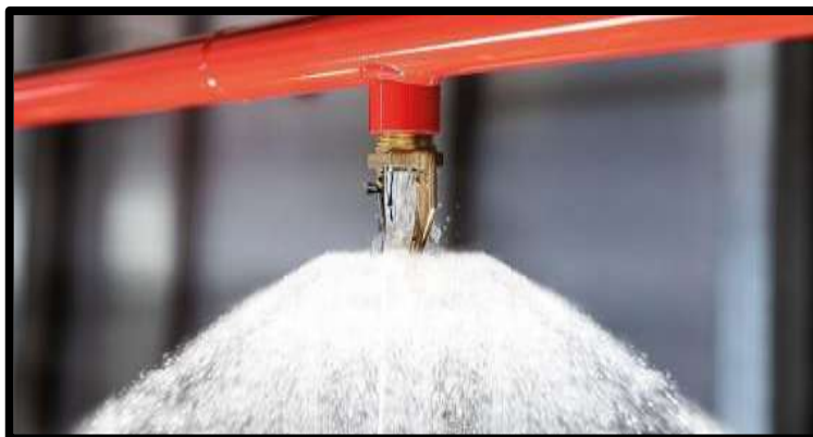
Figura 12: Sprinklers contra incendios Fuente: Extintores Huelva A2J (2022).
