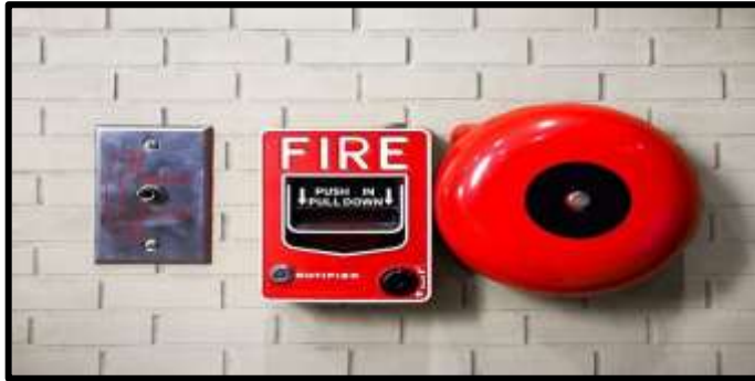
Figura 10: Alarma contra incendios. Fuente: NOVASEP (2020).
